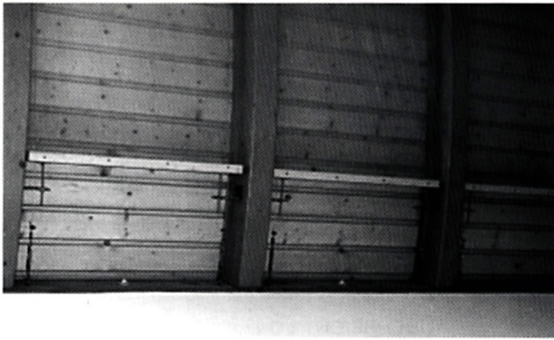
Bild 3: Foto der Folienabsorber zwischen den Sparren der Dachkonstruktion.
