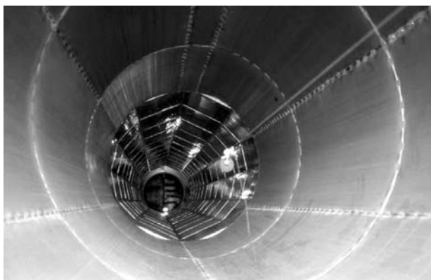
Bild 1: Foto von der Mündung aus in den Schornstein-Schalldämpfer bei Abnahmemessungen: Ein Mikrofon wird durch den Schalldämpfer gezogen. vorn: Poröser Absorber hinter Lochblech, hinten: Eckiger Innenzug
