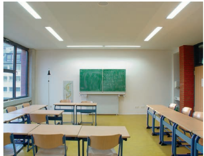
Beleuchtung eines Klassenraumes mit Langfeld-Rasterleuchten. Quelle: licht.de.
