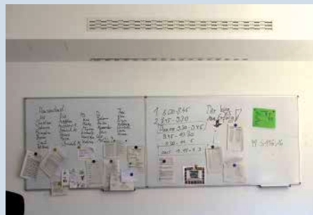
Abb. 24: Deckenauslässe der Lüftungsanlage Foto: Gymnasium Neutraubling
