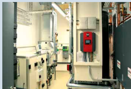
Abb. 71: Der Technikraum Foto: Haase & Bey Architekten
