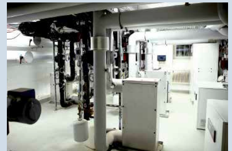
Abb. 25: Blick in die Technikzentrale Foto: Gymnasium Neutraubling
