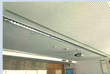
Abb. 48: Zuluft-Schlitzschienen in den Decken Foto: Stadt Kaufbeuren
