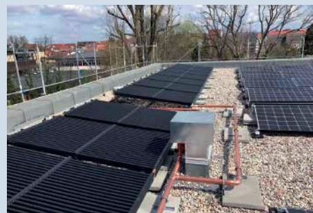
Abb. 13: Die Solarthermie-Anlage Foto: Ingenieurbüro Willhaug
