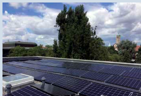
Abb. 12: Die Photovoltaik-Anlage Foto: Rhein-Neckar-Kreis
