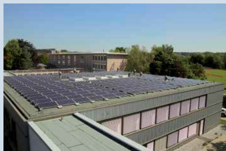
Abb. 46: PV-Anlage auf dem Dach des Neubaus Foto: Güttinger Ingenieure
