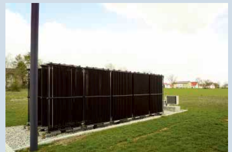
Abb. 60: Der Solar-Luftabsorberblock Foto: Stadt Feuchtwangen
