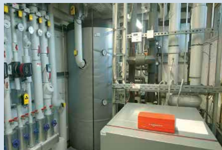
Abb. 59: Die Haustechnikzentrale Foto: Stadt Feuchtwangen
