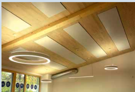
Abb.70: Integrierte Deckenheizung, LED-Leuchten Foto: Haase & Bey Architekten
