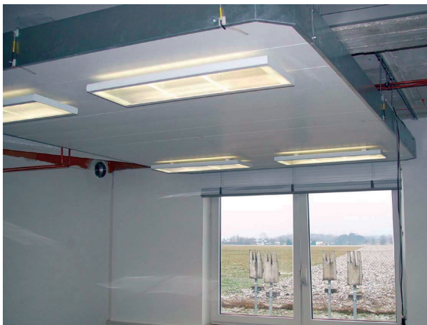
Bild 1: Klimasegel mit integrierten Beleuchtungskörpern.
