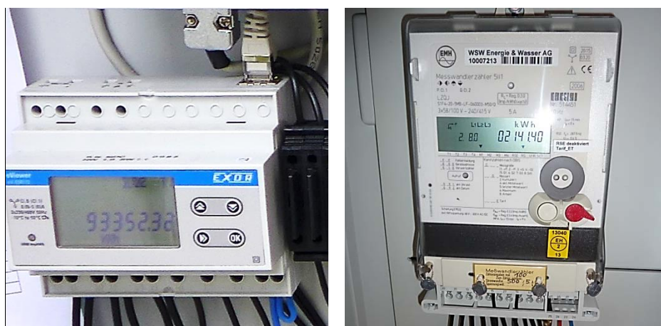
Bild 25: Ringzähler mit Datenschnittstelle und Display (links) und Abrechnungszähler der Stadtwerke Wuppertal (rechts).
