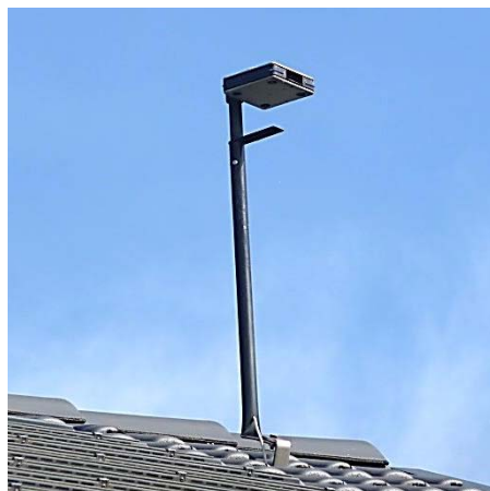
Bild 26: Wetterstation auf dem Dach des 07_HUF HAUS-Gebäudes.
