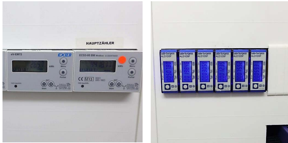
Bild 21: Stromzähler mit Display und Datenschnittstelle (links: Hauszähler, rechts Zähler zur Erfassung der Einzelverbraucher einphasig).
