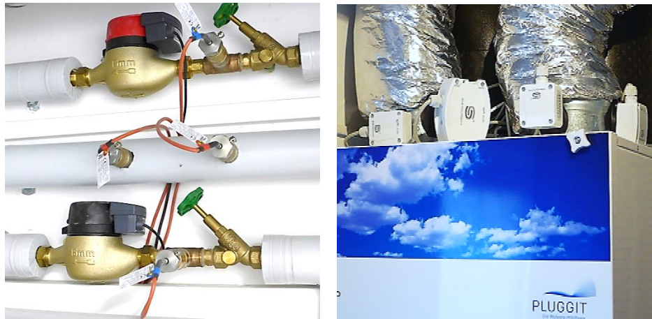
Bild 23: Wärmemengenzähler zur Erfassung des Warmwasserverbrauchs und der Zirkulationswärmeverluste (links) bzw. Volumenstrom- und Temperatursensoren in den Lüftungsleitungen (rechts).
