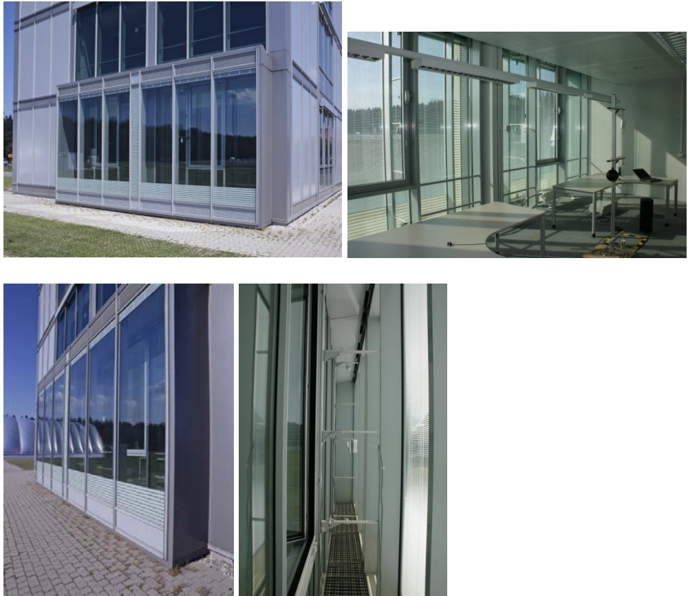
Bild 31: Außen- und Innenansicht Versuchsraum EG-S1M1 mit Blick in die Doppelfassade.
